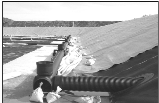
Abbildung 2 Sammler und Schächte im Filterbecken zur Fassung und Ableitung des gereinigten Oberflächenwassers
